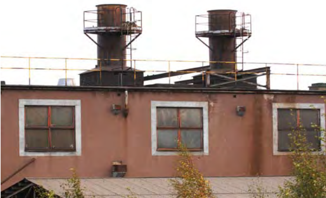
Ventilationsskorstenarna på taket är direkta signaler på att det finns ett gjuteri i lokalerna. Skorstenarna är placerade rakt över de två kupolugnar som under lång tid har fungerat som *"hjärtat"* i verksamheten. Vid en eventuell renovering av byggnaderna är det av stor vikt att dessa skorstenar får finnas kvar. Foto: SOA 2008.
