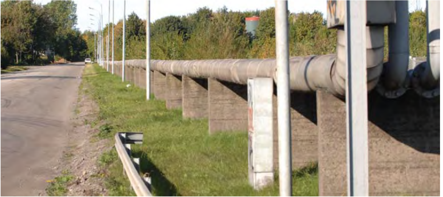
Längs Strandgatan norr om kvarteret Kniven och Pumpen löper en pipeline som förbinder cisternerna med hamnen. Rörledningarna som vilar på skivformade betongfundament är isolerade för att underlätta pumpning av tjockolja under den kalla delen av året. Foto: SOA 2008.
